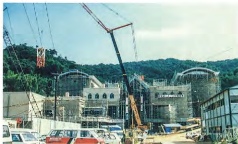
▲1989(平成元)年8月7日 三館棟北側より 三館棟工事で活躍をしていた巨大なクレーンを解体撤去している。建築工事はほぼ終了し、内装・外装工事を残すのみとなった。
